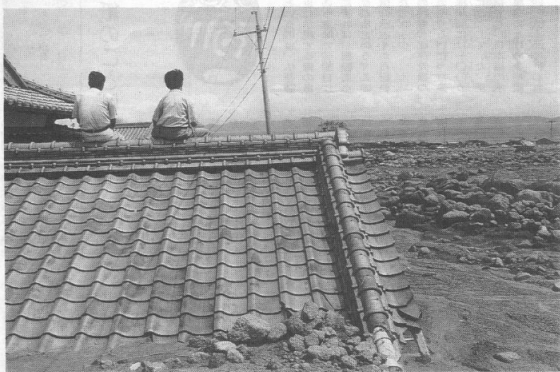
壊された家の屋根で茫然とたたずむ
